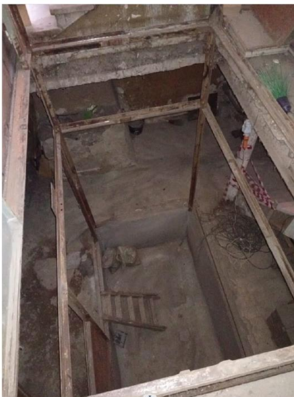
Вид на приямок шахты лифта и шахту лифта после демонтажа сетки Рабица. Фото 12.2025г.
