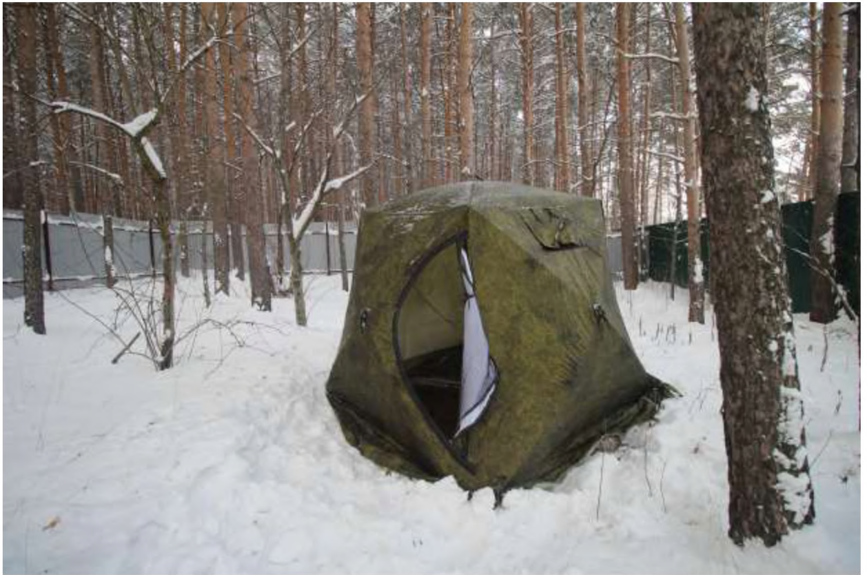
Рис. 24. Свердловская область, г. Первоуральск, ул. Физкультурников. Земельные участки с кадастровыми номерами 66:58:0113004:2060 и 66:58:0113004:2068. Шурф №1. Вид на выполненный шурф №1 с установленной палаткой с востока.
