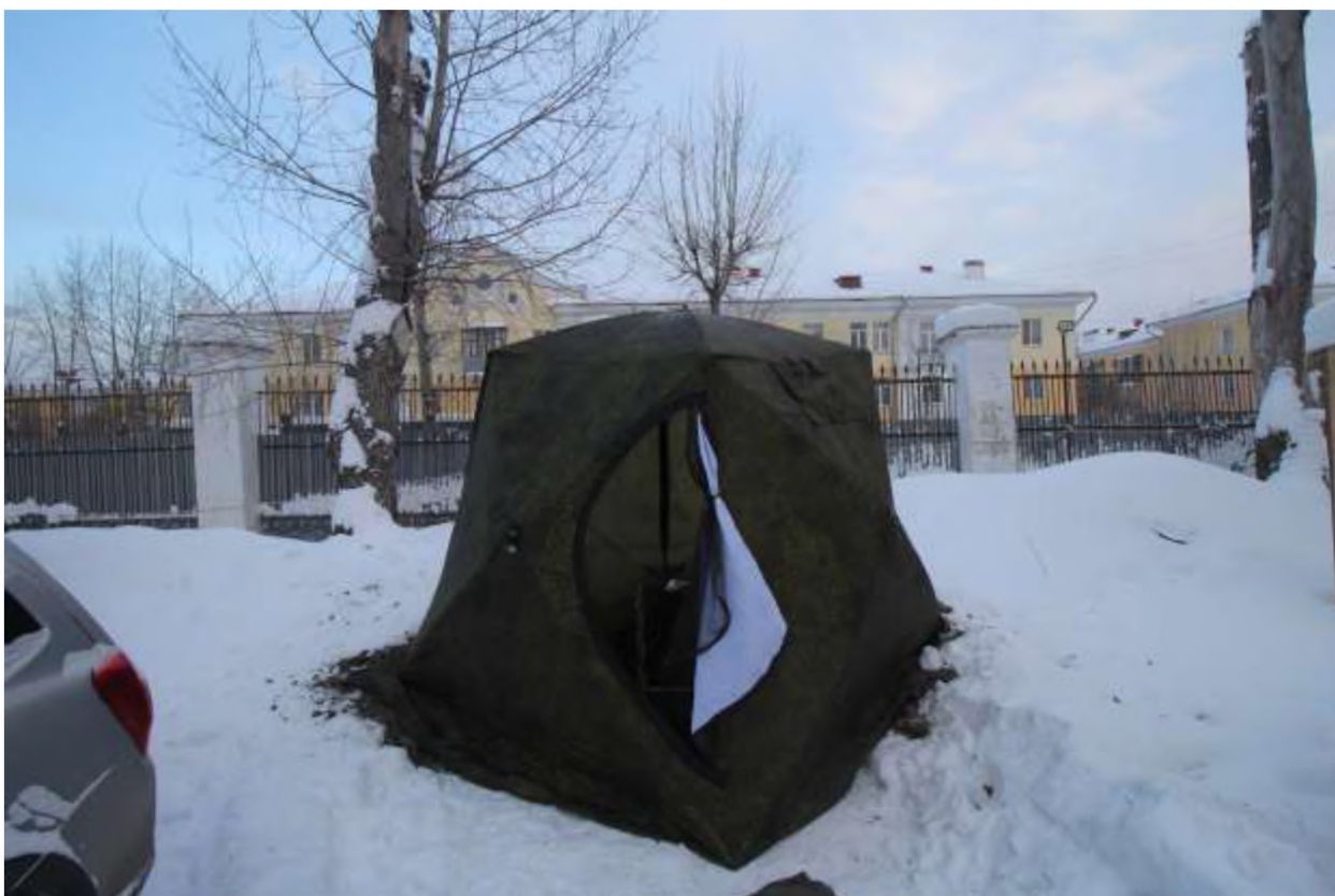
Рис. 30. Свердловская область, г. Первоуральск, ул. Физкультурников. Земельные участки с кадастровыми номерами 66:58:0113004:2060 и 66:58:0113004:2068. Шурф №2. Вид на выполненный шурф №2 с установленной палаткой с запада.
